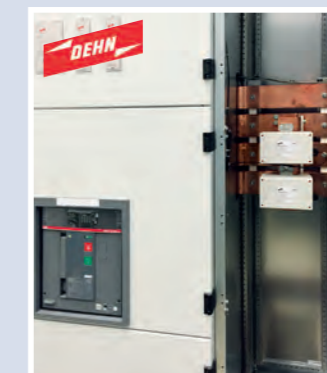
VAMOCON-Anlage mit System DEHNshort
