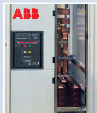
Installation VAMOCON avec système ABB UFES
