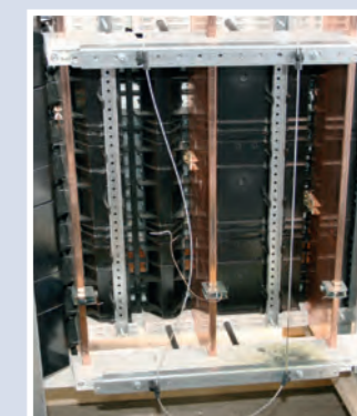
Après un essai réussi: Fil d'amorçage d'arc électrique après coupure par un système DEHNshort
