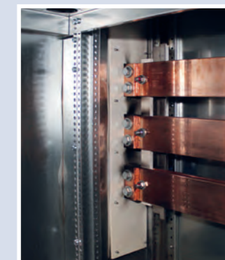
Un dépôt infime de calamine pouvant être éliminé par nettoyage est visible sur la baie adjacente.
