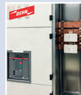
Installation VAMOCON avec système DEHNshort
